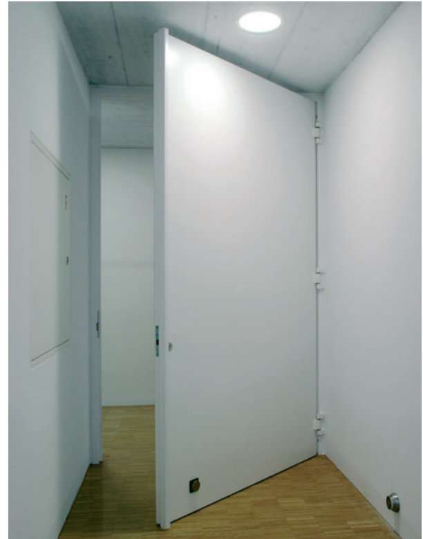
Brandschutzgesteuerte Zonentrennung durch Elektrotür-Magnet
