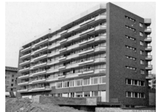
Das Schwamendinger Werkstattgebäude während der Fundierungsarbeiten für das 7-stöckige Wohn- und Geschäftshaus.
